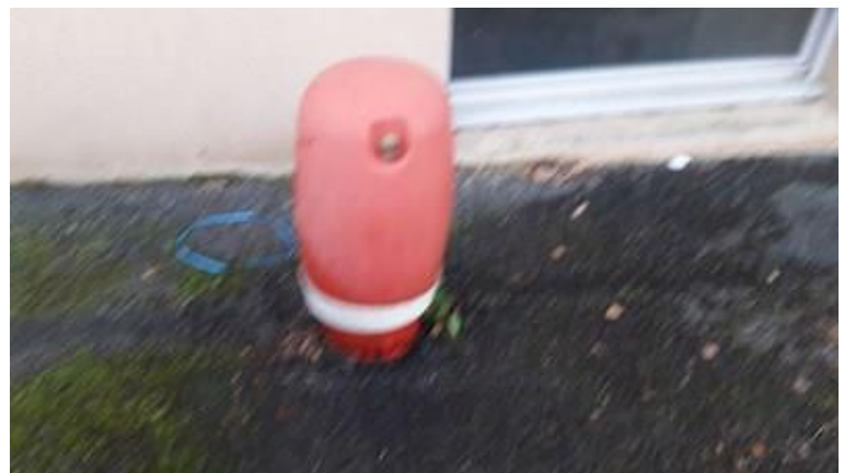
Photo de l'hydrant
